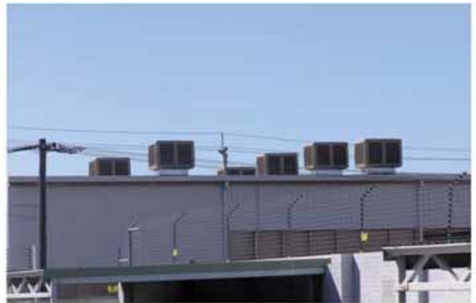
Instalación con 6 Evaporativos FD 500
