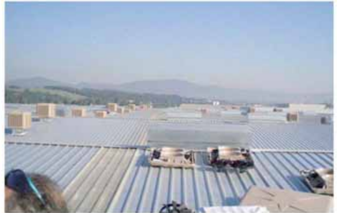
Vista de una gran nave con 39 equipos
