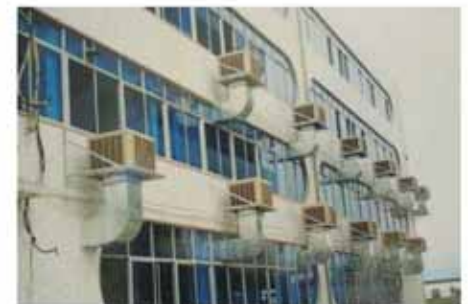
Evaporativos en edificio de varias plantas
