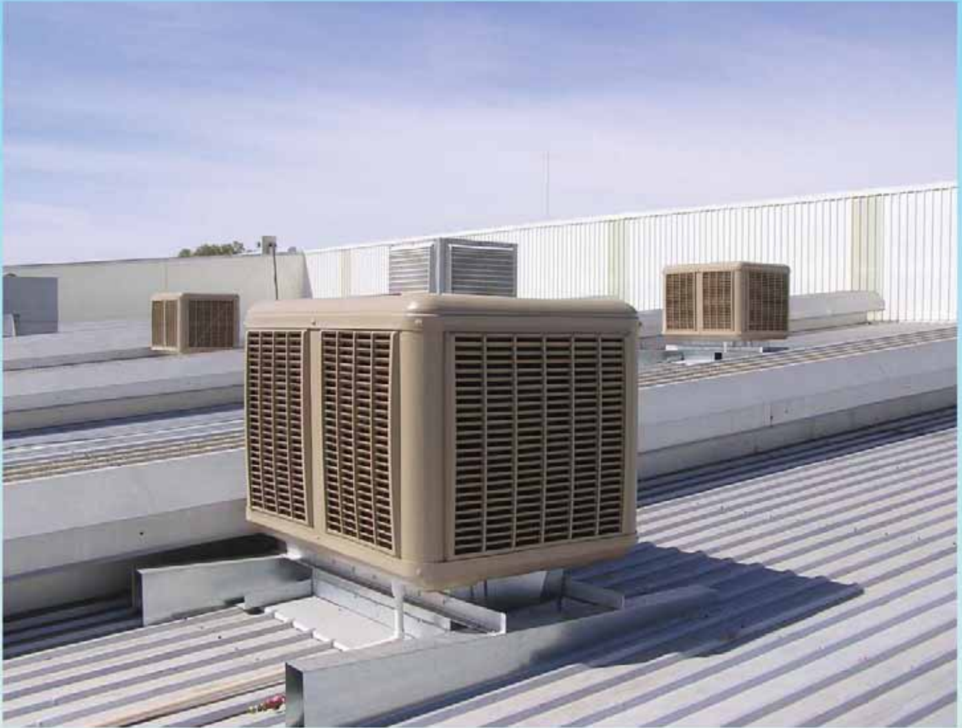
Evaporativos TECNA COOL BREEZE FD 500 en una fábrica
