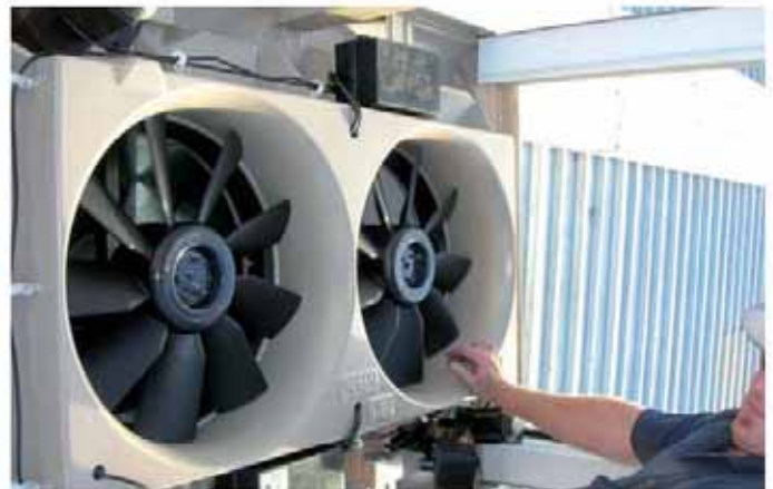
Comprobar el funcionamiento de los motores
