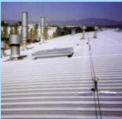
La línea de vida en el tejado protege cualquiera intervención en el tejado
