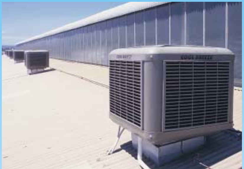
Necesario para el montaje de evaporativos y su posterior mantenimiento anual
