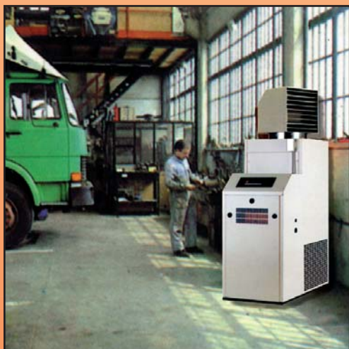
Generador autónomo SERIE MIG con plenum instalado en un taller mecánico
