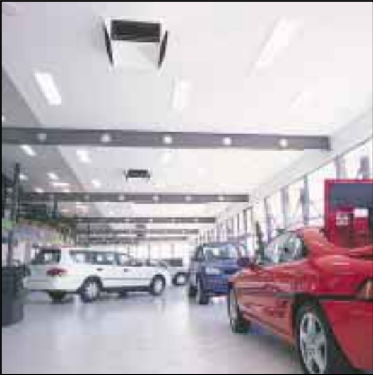
6 Evaporativos instalados con difusor en el techo, en una exposición de automóviles TOYOTA. Las grandes superficies acristaladas hacen que la instalación de evaporativos sea la solución más económica
