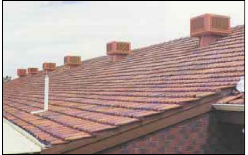
7 Evaporativos instalados en una Escuela Primaria. La reducción de las calurosas temperaturas estivales, permiten a los niños concentrarse mejor.
