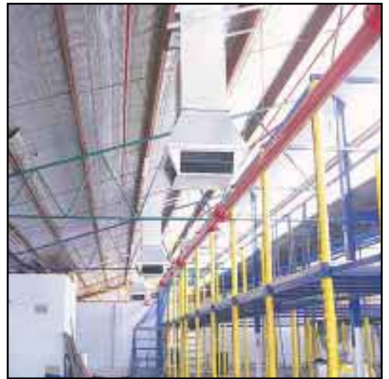
Los evaporativos en locales industriales mejoran el confort aumentando la productividad con un coste muy bajo
