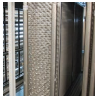
Baterfas de calentamiento y enfriamiento con agua
