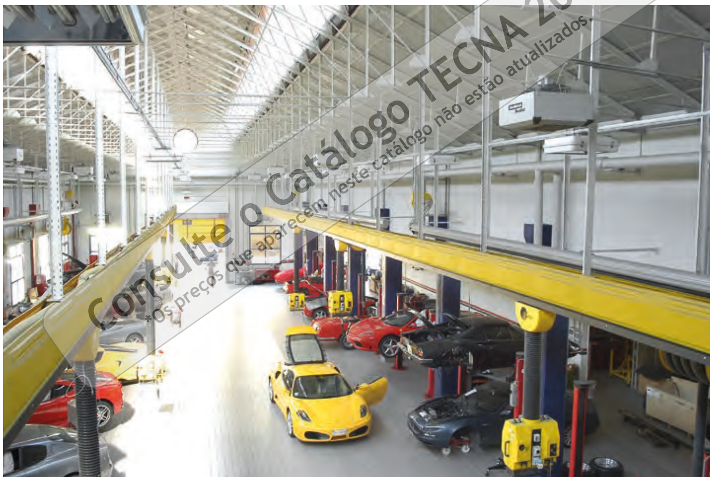
Instalação de destratificadores TECNA SABIANA NO STRAT na fábrica da Ferrari, Módena, Itália.
