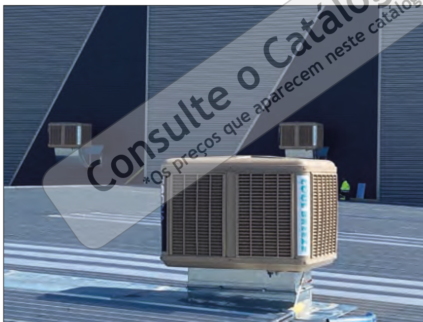
Instalação de 18 unid. QA-500 integrados com o controlo doméstico INTELLITOUCH no novo armazém da NISSAN (Ávila)
