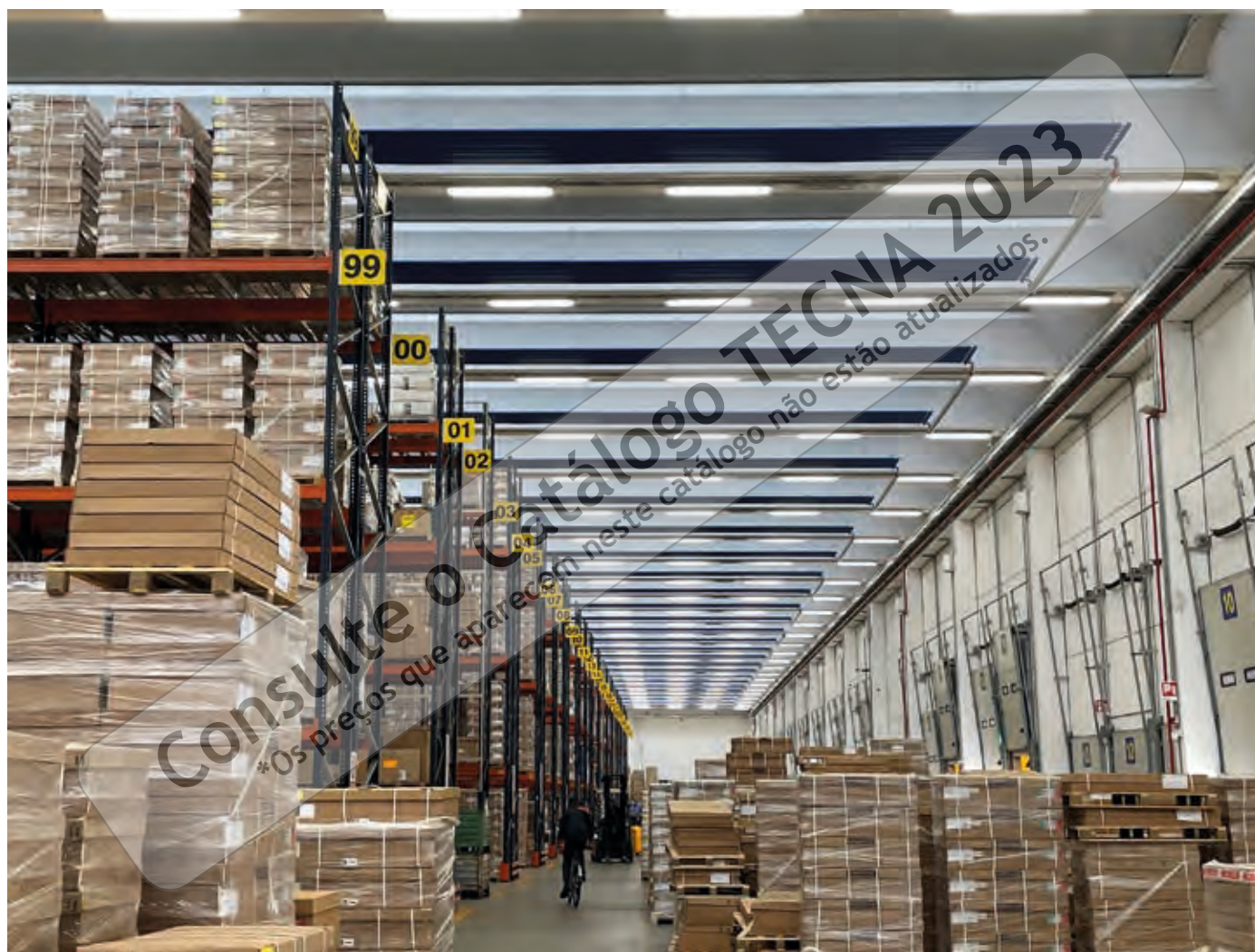
Instalação de aquecimento com painéis radiantes SABIANA no armazém da SABIANA (Itália).
